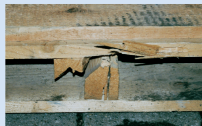
Kantholz angebrochen/ gebrochen
